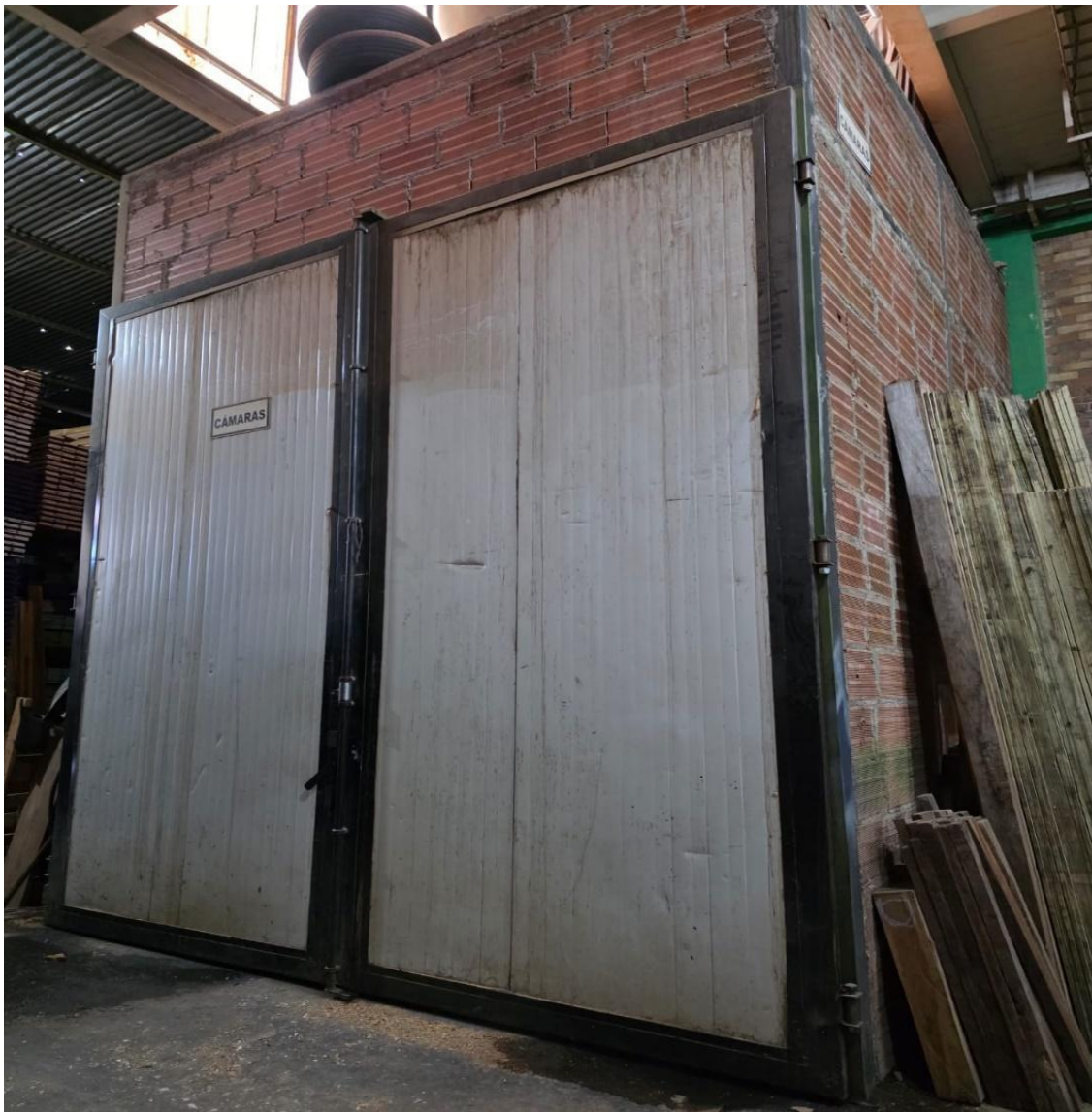
Cámara de secado a Gas
